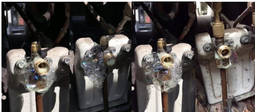
Fotos do vazamento nos flanges
