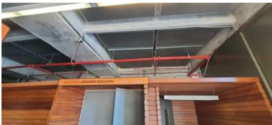
Essa é uma tubulação secundária maior, onde alimenta de forma direta os bicos de sprinklers.
